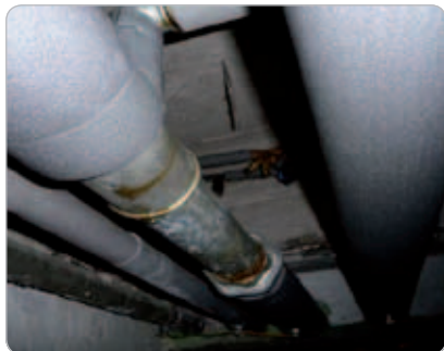
Obr. 3 Pohľad na poškodené potrubie TUV dôsledkom bludných prúdov
