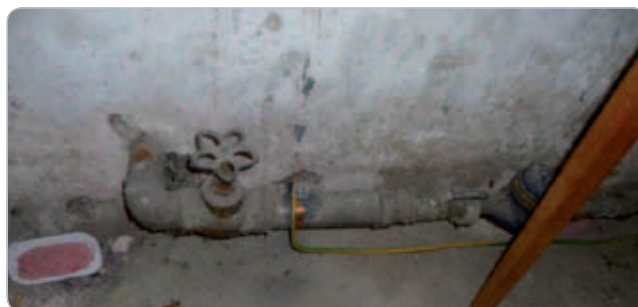
Obr. 5 Miesto vstupu bludného prúdu do predmetného objektu (prívod vody č.4)
