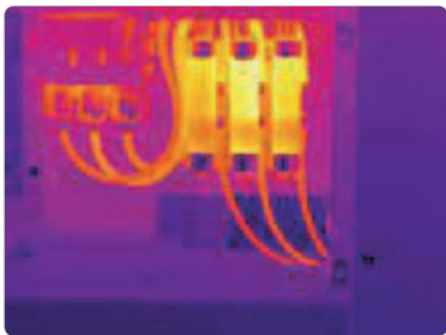
Obr. Ukázka kontroly zatížení/přetížení kabelových svazků a přípojních míst, jakou jsou např. pojistkové skříně.
