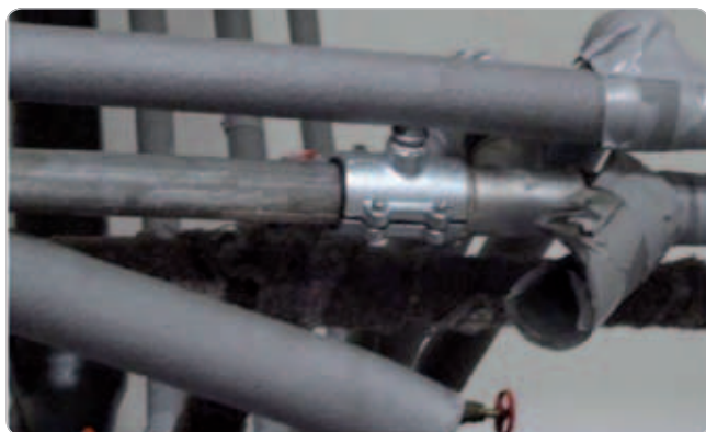
Obr. 4 Pohľad na opravenú časť potrubia TUV poškodeného bludným prúdom
